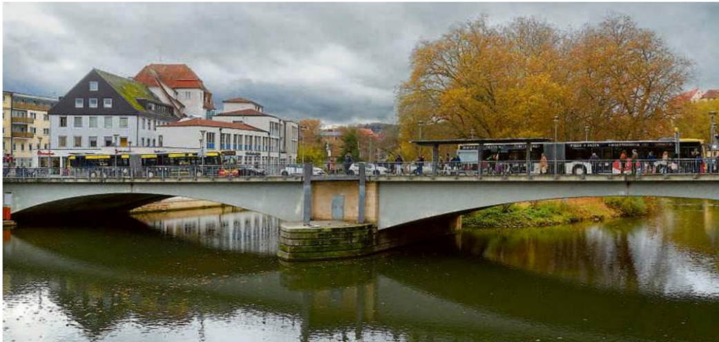
Die Bögen der Eberhardsbrücke sind aus Stampfbeton. Eine Stadtbahn drüberfahren zu lassen, wäre zu riskant, sagen Gutachter. Bild: Metz
